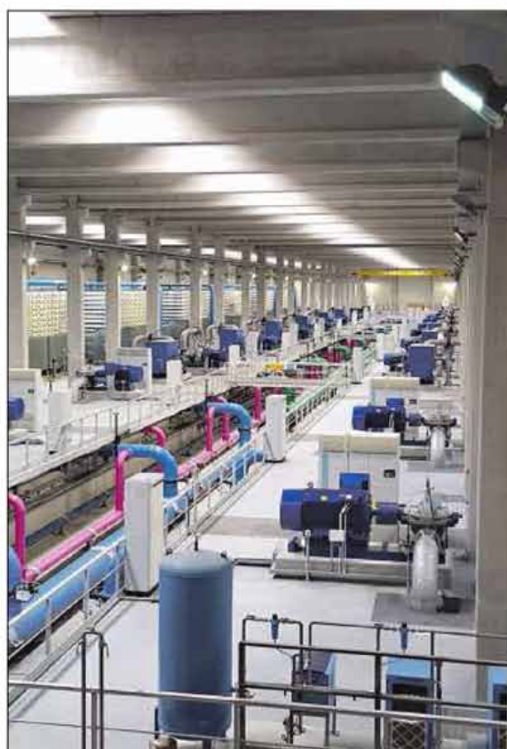
Planta de tratamiento de GS Inima EE
